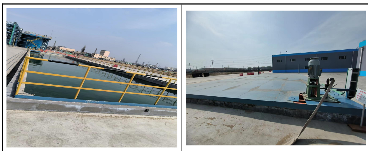
图 4.2-1 冷凝水收集池
