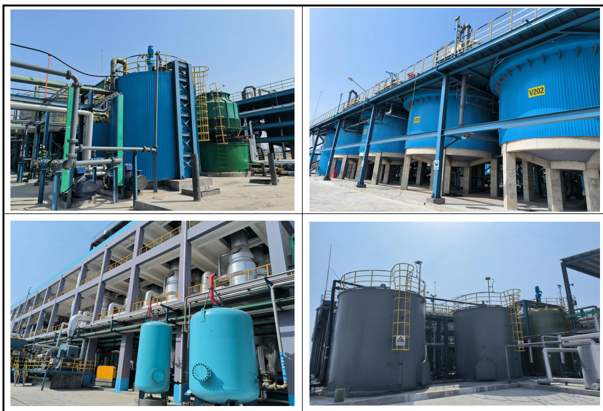
图 4.2-2 生产装置区及罐区
