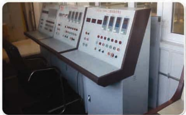
哈尔滨电气动力装备公司绝缘试验站 绝缘、老化试验工频试验控制台
