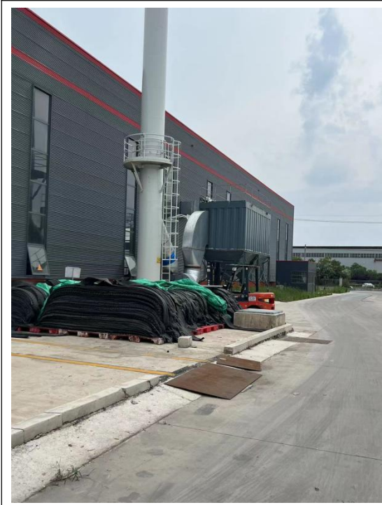
2号废气排放口
