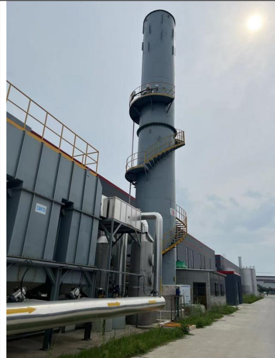
4号废气排放口
