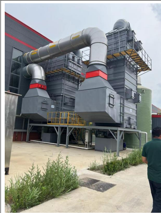
废气处理设施
